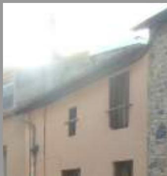
Garde-corps extérieur sans appui saillant : à proscrire
