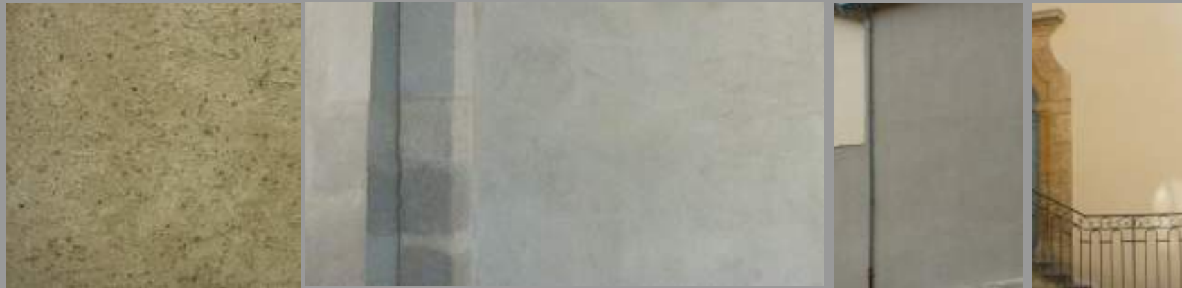
Enduit plein au mortier de chaux teinté dans la masse, finition grattée à la truelle.
