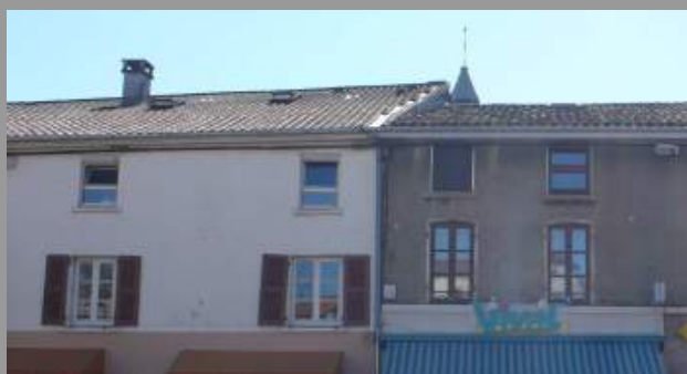
Les ouvertures des combles sur la façade de gauche sont suffisamment décalées par rapport à la toiture, celles de droite ne le sont pas.
