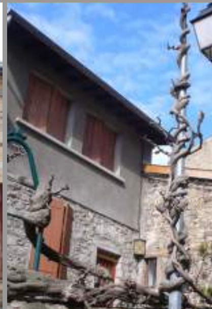
Appui fin et continu en béton : à proscrire
