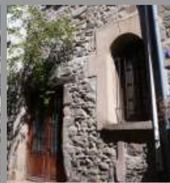
Baie en plein cintre : création fantaisiste et « faux-vieux » à proscrire
