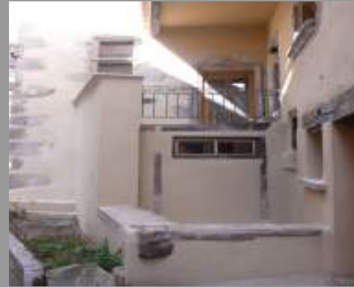
La maison du prieur: la mise en œuvre de l'enduit doit être améliorée, notamment la jonction 'enduit/pierre apparente'
