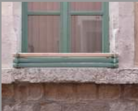
Garde-corps « jardinière » en bois inadapté
