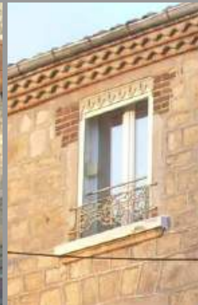
Lambrequins à conserver, à restaurer et reproduire Coffre volet roulant trop visible à supprimer
