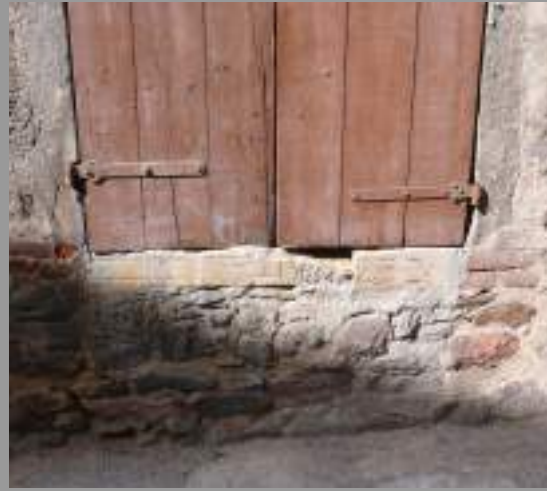
Réemploi d'un jambage en appui de fenêtre acceptable
