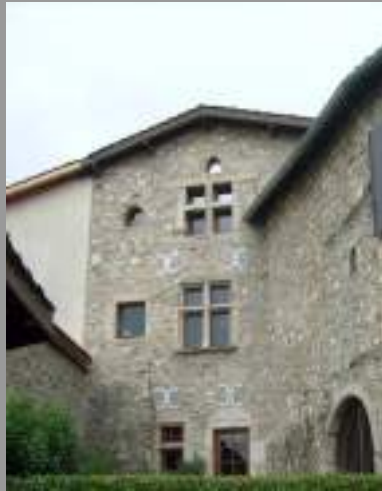
Fenêtre à meneau à maintenir ou restaurer si nécessaire, "oculi" existants à conserver
