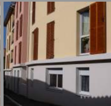
Ouvertures des étages trop étroites, taille des baies du RDC trop petite/taille des baies des étages et désaxement/travées peu harmonieux : à éviter
