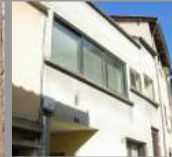
Menuiserie à fleur de façade à interdire
