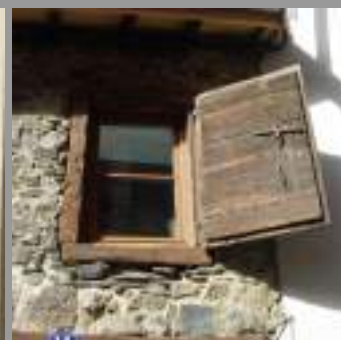
Volet bois à un vantail autorisé pour les petites fenêtres des combles
