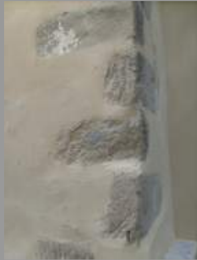
Enduit en sur-épaisseur autour de la chaîne d'angle à proscrire
