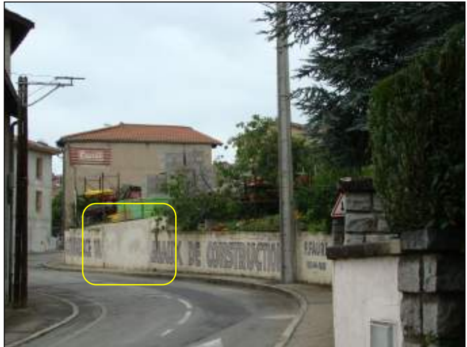
Figure 20 : Mur de soutènement reconstruit avec des drains en pied, au niveau de l'entreprise F. FAURE (rue Boiron). A noter que le reste du mur présente une fissuration importante [Source : IMS RN ]
